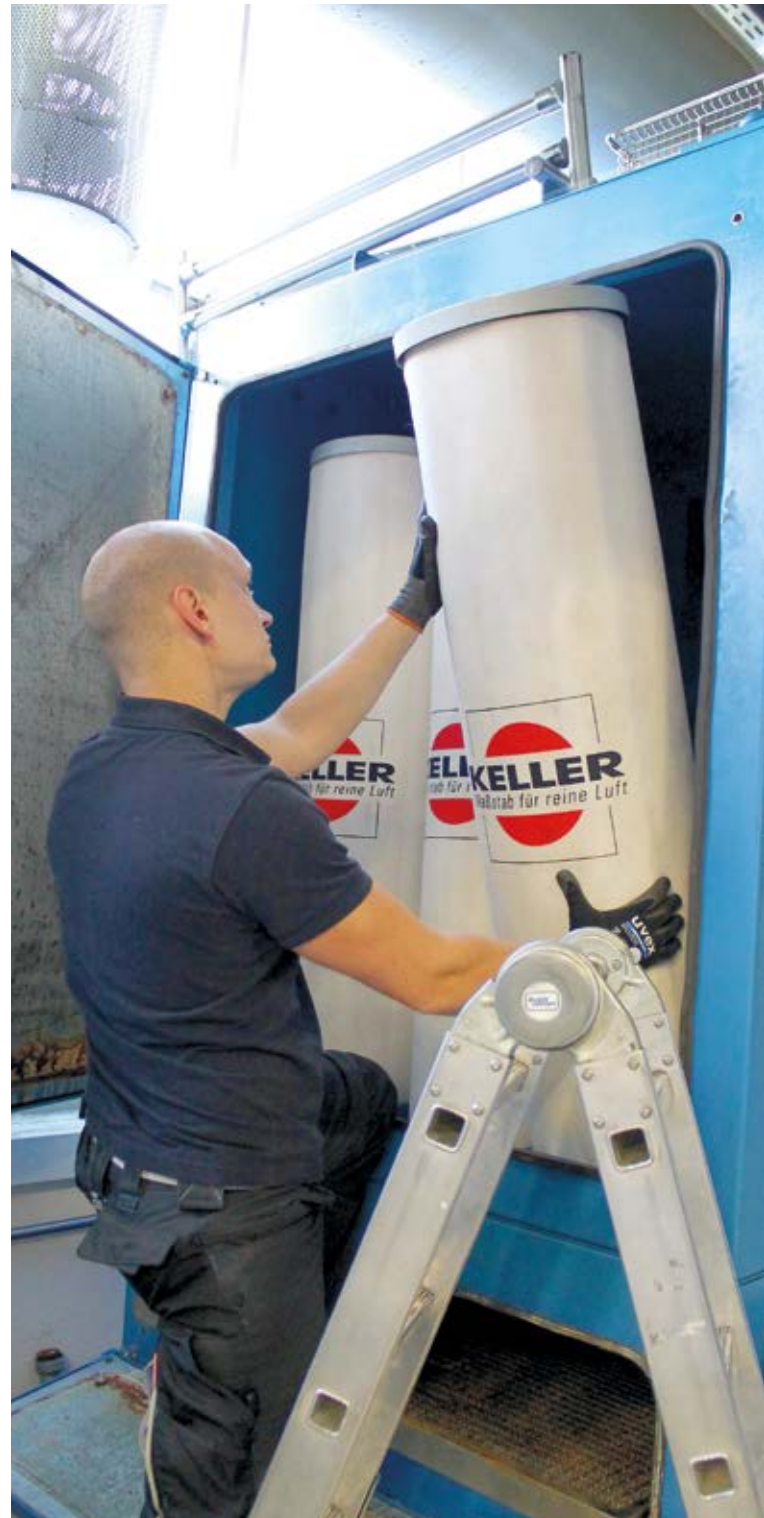
Turnusmäßig prüft ein Servicetechniker von Keller Lufttechnik die beiden Ölnebelabscheider, die die Rauchgase aufnehmen, Fremdstoffe aus der Luft filtern und diese gereinigt aus der Halle fortleiten.
