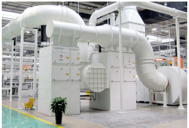
Absaugung einer LKW-Motorenfertigung mit einem Volumenstrom von 140000 m 3 /h
